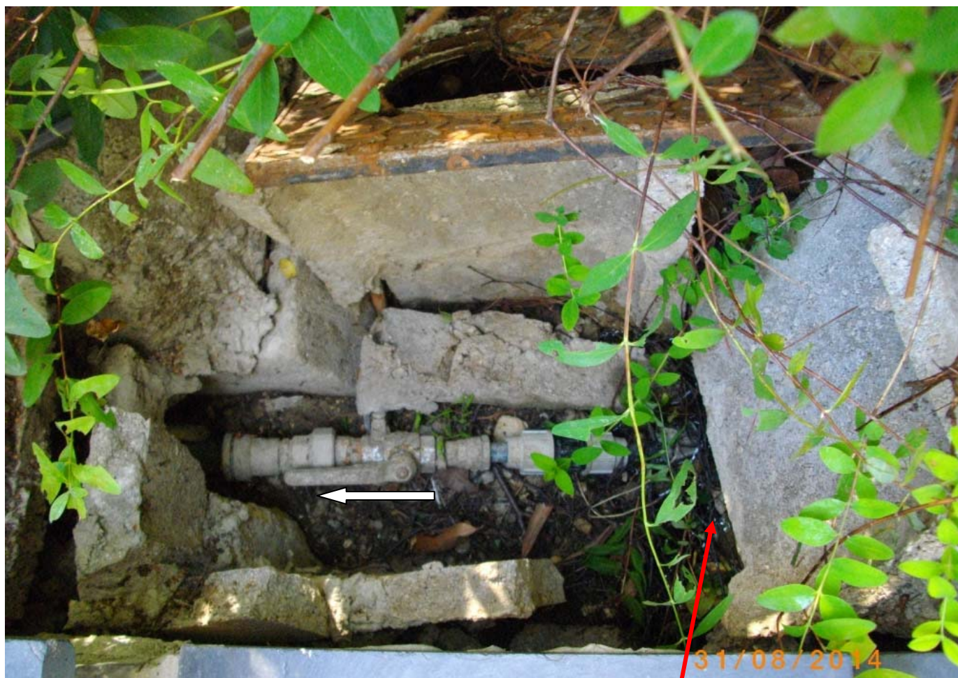
Eau de fuite
